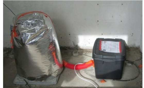
Station sismologique A170A installée à St Gérard de Vaux (03). Le capteur est placé sur une dalle en béton sous une capuche isolante. Le numériseur et la batterie sont dans la caisse en plastique noir. L'antenne GPS est à l'extérieur du bâtiment.
